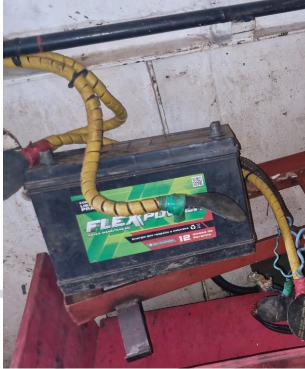
Figura 19- Estado atual das baterias.
