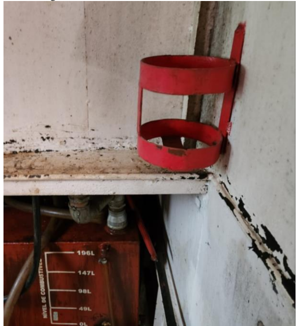
Figura 27 – Extintores a serem substituídos.
