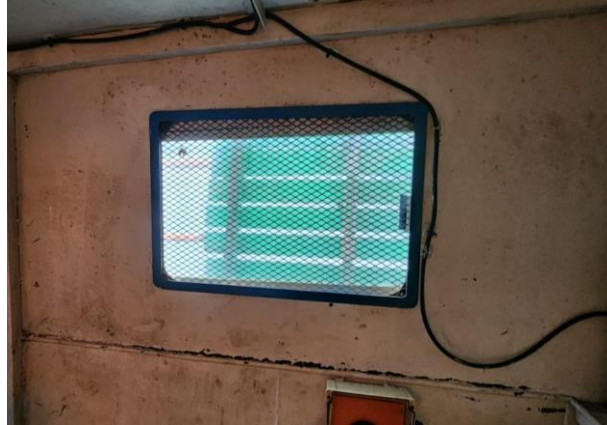
Figura 10 – Vidro da praça de máquinas
