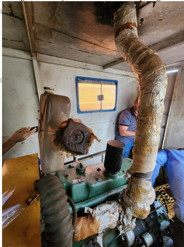
Figura 5 - Proteção térmica da rede de escape de gases.
