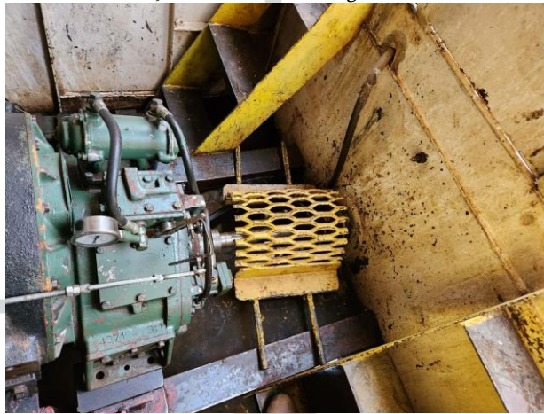
Figura 11 – Eixo da embarcação, sistema utilizado gaxeta, recomenda-se substituição.
