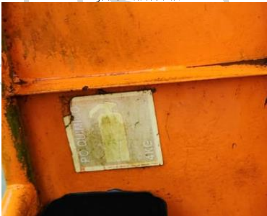
Figura 23 - Placa de extintor.
