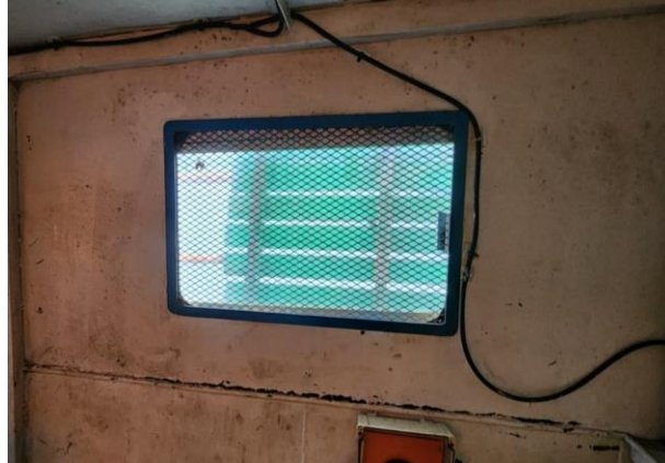
Figura 10 – Vidro da praça de máquinas
