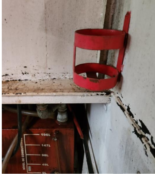
Figura 27 – Extintores a serem substituídos.
