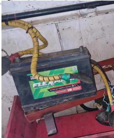
Figura 19- Estado atual das baterias.
