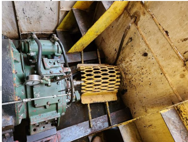
Figura 11 – Eixo da embarcação, sistema utilizado gaxeta, recomenda-se substituição.
