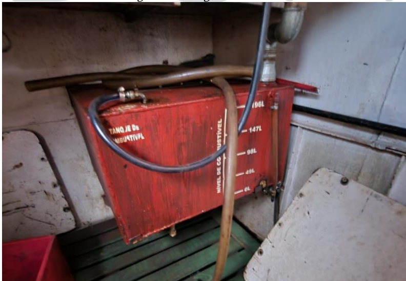
Figura 9 - Mangueira de nível.
