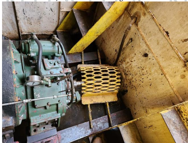
Figura 14 – Eixo da embarcação, sistema utilizado gaxeta, recomenda-se substituição.
