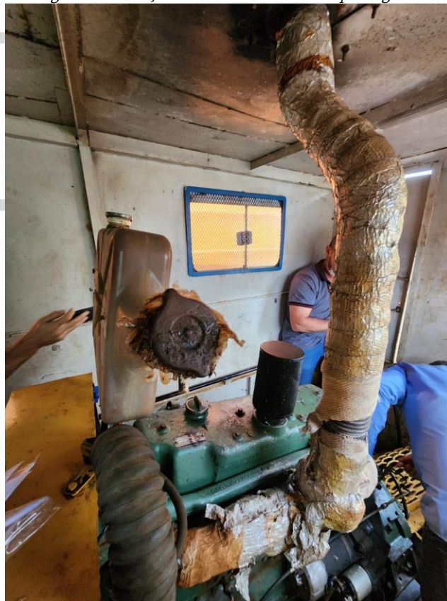
Figura 7 - Proteção térmica da rede de escape de gases.
