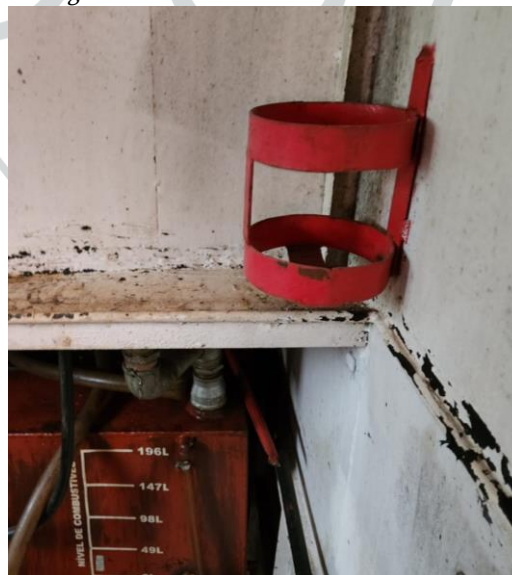
Figura 30 – Extintores a serem substituídos.
