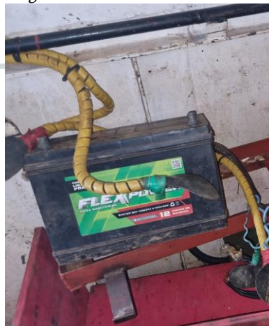
Figura 22- Estado atual das baterias.
