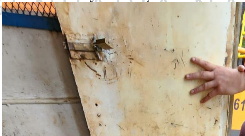
Figura 11 - Trinco da porta.
